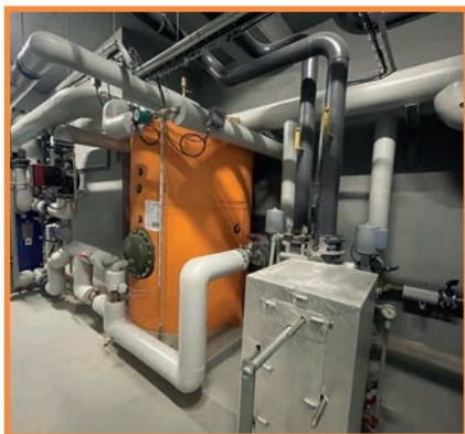
Sous-station du centre aquatique Annette Kellermann
